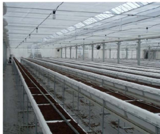
内部設備 (プランター式栽培ベッド)
